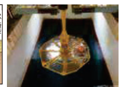
図2 今回設置予定の孔内観測所の孔口部分(前回設置の様子)
