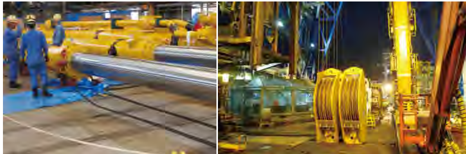
掘削部の整備の様子。パイプをつり上げるクレーンや海中に下ろしたパイプを支えるライザーテンショナーのシリンダーは外して整備・交換される(左)。デリックの最上部にあるクラウン・ブロック(固定滑車)も下ろして整備をする(右)。
