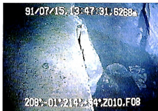
写真25 溝の壁面に見られる落ちかかったブロック Photo 25 Block just before to fall.
