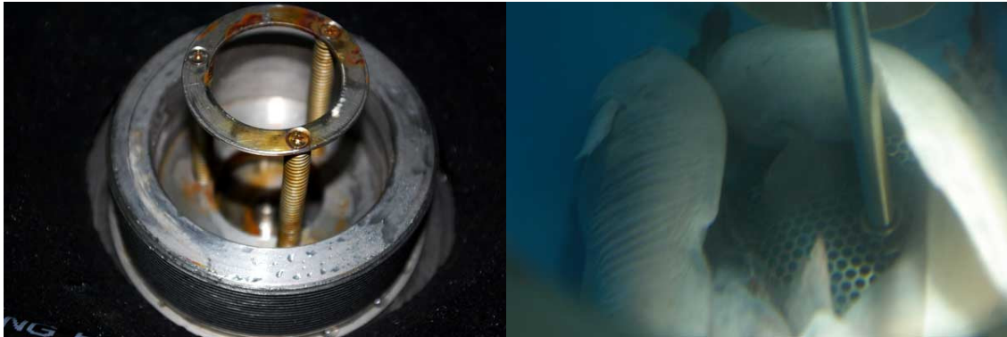
1) 閉鎖不良を生じた弁
