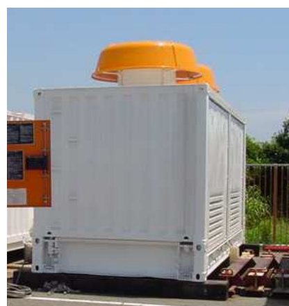
写真 2 : コンプレッサー外観
