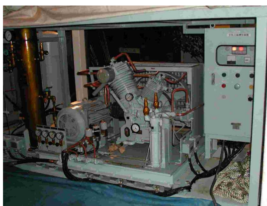
写真 1 コンプレッサー
