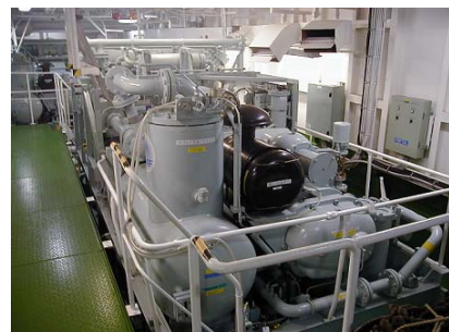
写真-1 エアガンコンプレッサー（1台）
