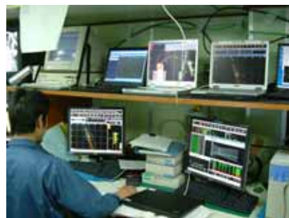
写真-4 各種制御モニター
