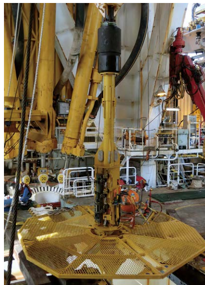
図2.設置するLTBMSのデータ記録部
