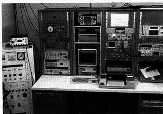
写真-2 中央の机上ラックに入っているのが自動校正装置、左にあるのは位置検出制御装置表示部
