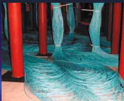
計算機室の床下、高さ1.5mのアクセススペースに施設されたネットワークケーブル。総本数は約83,000本、総延長2,890kmにも及ぶ。
