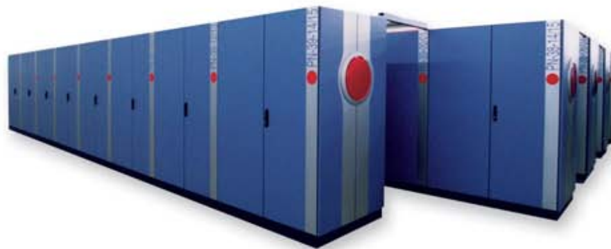
ひとつのキャビネット内に2計算ノードが収まり、広い計算機室には、これらの計算ノードキャビネットが320個、結合ネットワークキャビネットが65個並んでいる。
