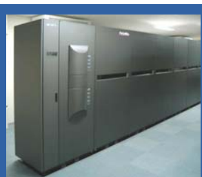
マシン室に設置された容量400テラバイトのストレージサーバ(大容量記憶装置)。
