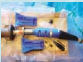
二次ケーブル引留部のカバー（ベルマウス）は内部が目視できるように改良された
