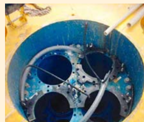
衛星通信装置や電池などが抜き取られた
