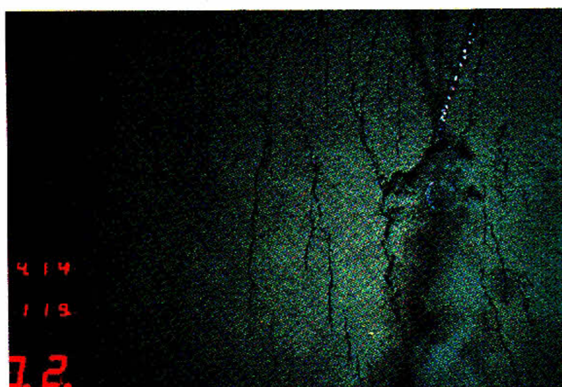
写真14 測線C-3 2 (14時14分41秒) 古い地割れ C-3 2 (14:14:41) Older cracks.
