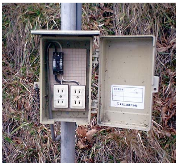
図4 清水観測点配電盤写真
