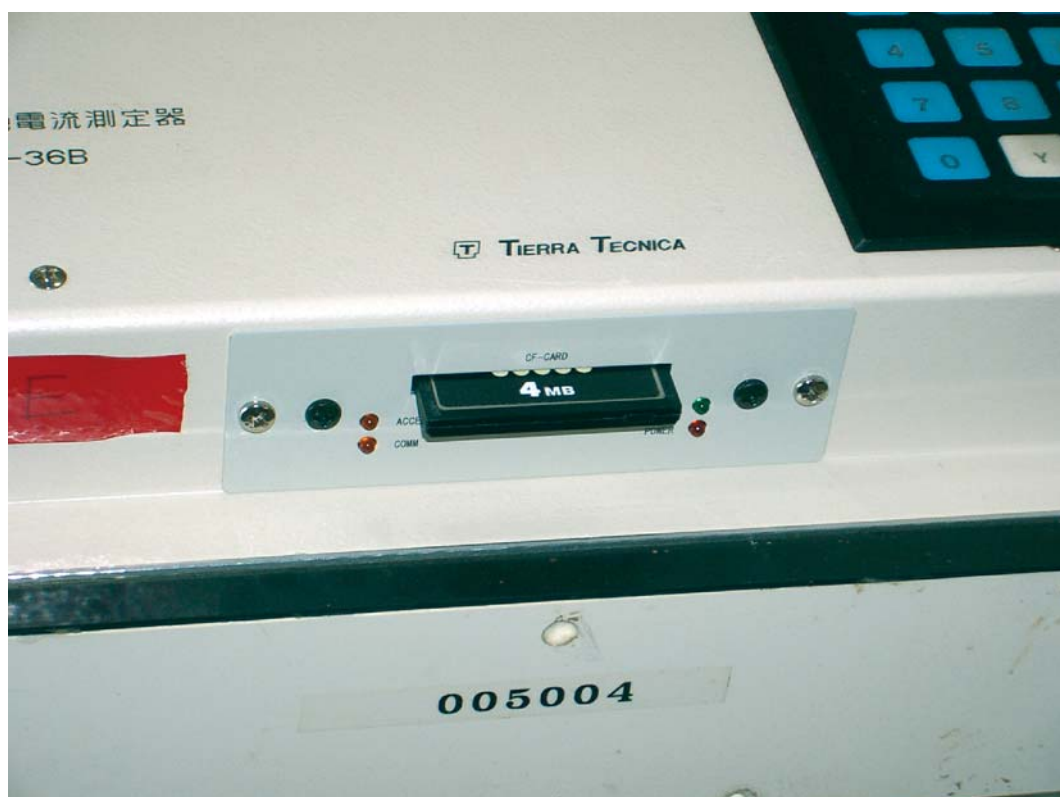
図8 換装したコンパクトフラッシュメモリドライブ
